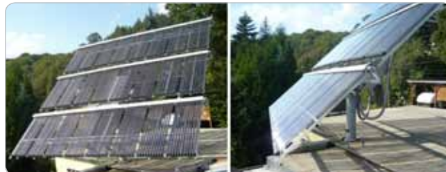
Obr. 3 Pohľad na otáčacie zariadenie pri 24 ks vákuových rúrkových slnečných kolektorov [7]
